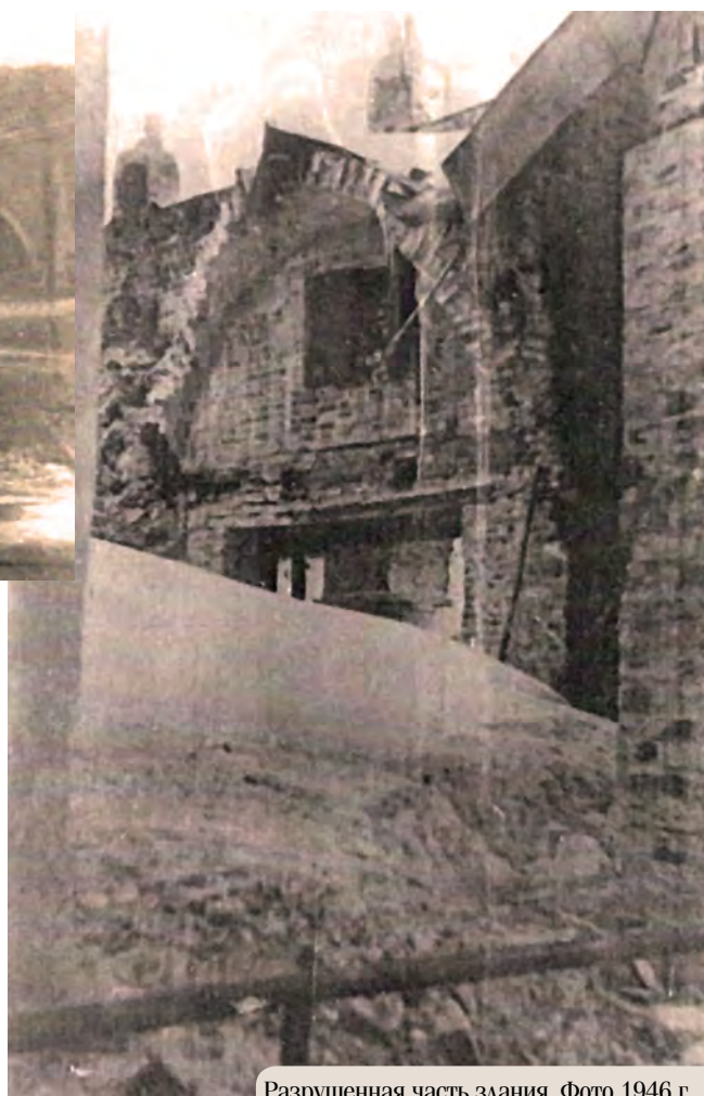
Разрушенная часть здания. Фото 1946 г.
